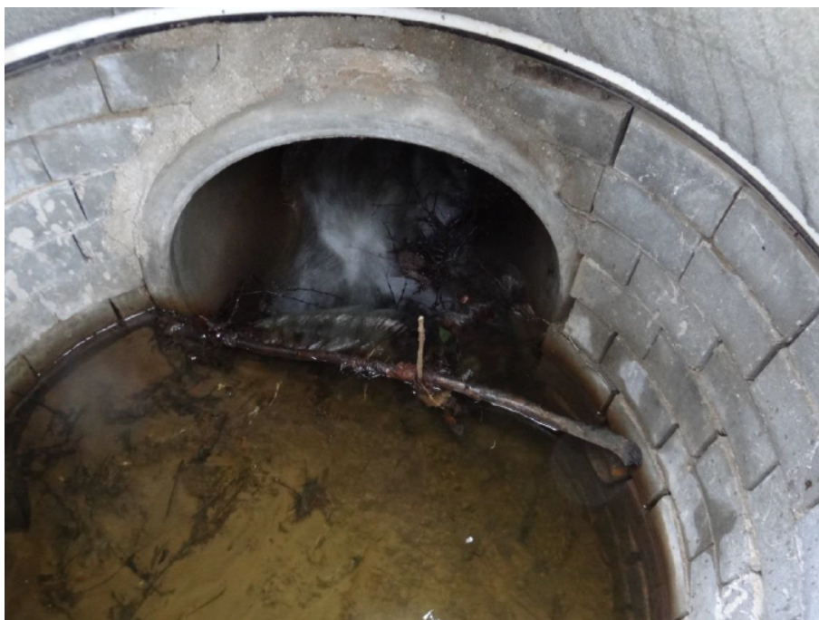
Foto 1: Vejbrønd der udgør et styrt ind i røret under vejen.
