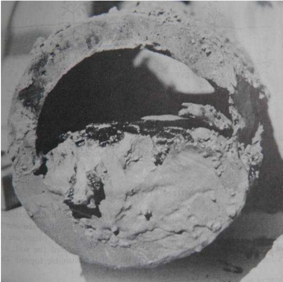
Figur 5.6. Forsidefoto. DHI rapport om drænanlæg. Drænrør, delvist tilstoppet på grund af sedimentation; dårlige udløbsforhold. 185
